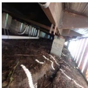
No Vapor Barrier
